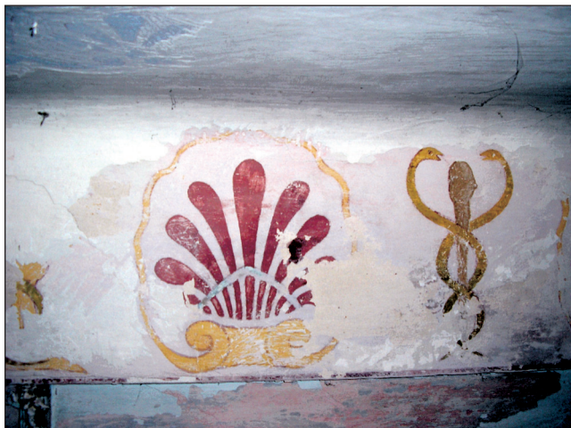
Figura 4. Remanescentes da pintura decorativa encontrada no roda-foro da circulação da biblioteca.
