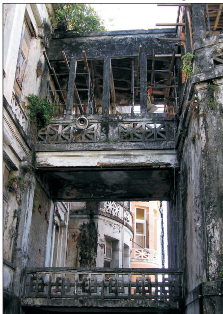
Figura 5. Vista externa da ligação entre a Biblioteca e o morgue, onde se observa a vegetação que se desenvolveu na cobertura, enraizando-se nas alvenarias e nos pisos.
