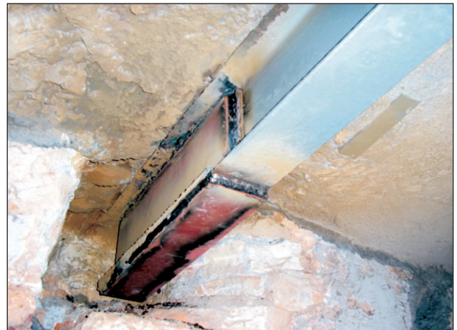
Figura 28. Serviços de reforço das extremidades dos perfis metálicos que sustentam os pisos da biblioteca.
