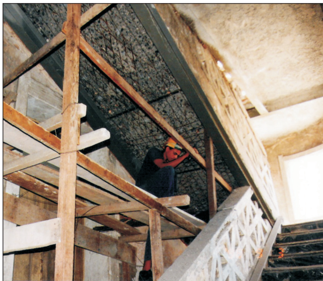
Figura 8. Aplicação da armadura de base na laje da escada da Biblioteca, antes do lançamento do concreto projetado.
