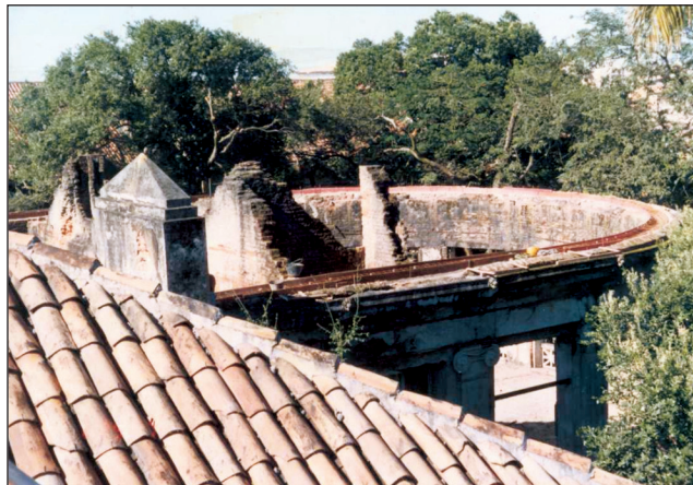
Figura 6. Rotunda do Anfiteatro Professor Alfredo Thomé de Britto após o desabamento da cobertura.
